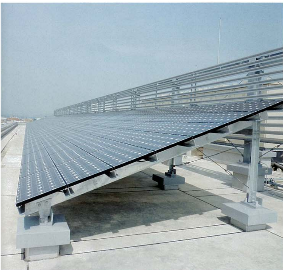
▲屋上太陽光パネル：東側より撮影
