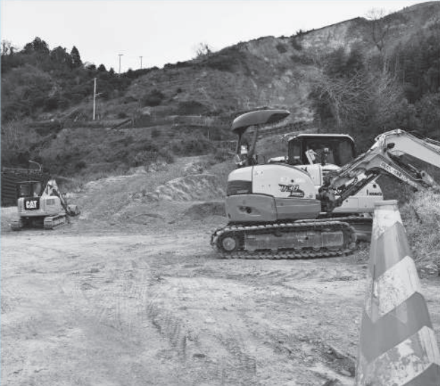
▲白浦地区の災害でえぐられた急斜面園地。山を削り谷を埋めてなだらかな地勢の園地にすべく、再編復旧が進む
