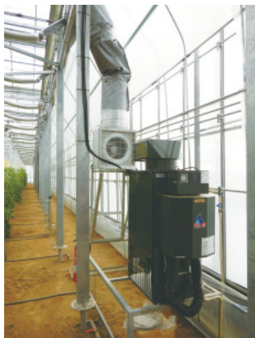
▲ヒートポンプ
