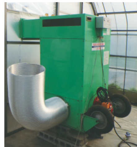
写真-3 ハウス内の加温室に設置された加温機
