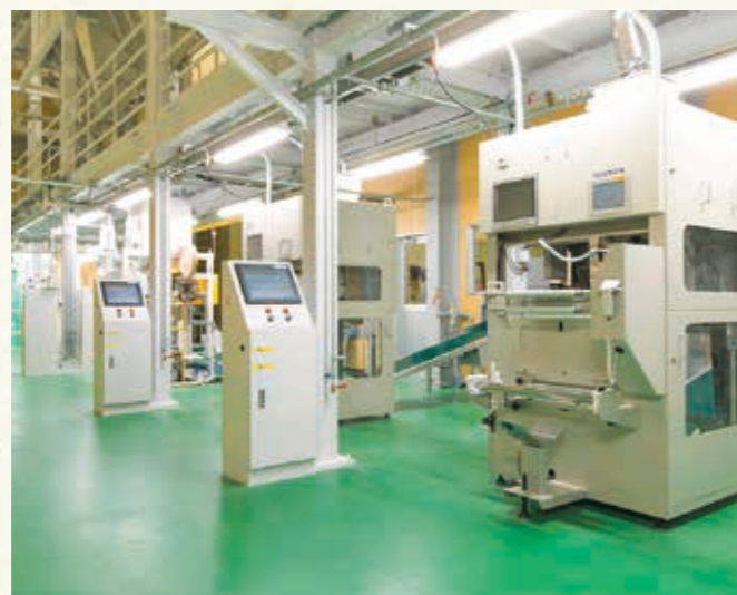
▲精米設備 コンパクトなパッカー
