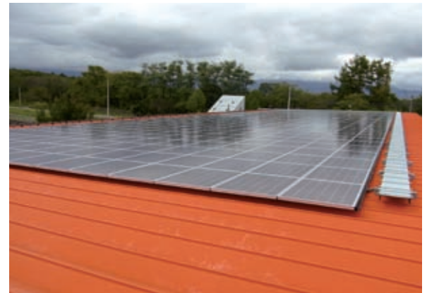
JAあがつま太陽光発電システム運転開始 (10.31～ JAあがつま西部農産資材センター)
