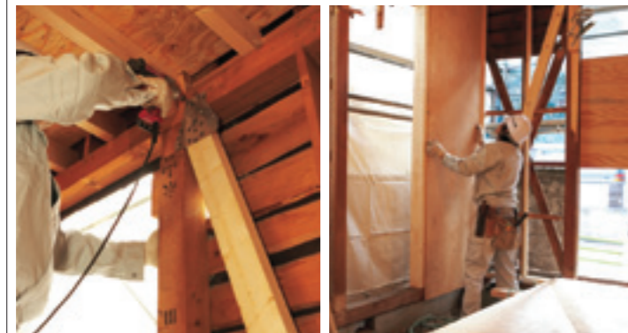
梁、土台、柱と筋交いを耐震金物で固定。断熱材を入れて、構造用合板を釘で留付け。
