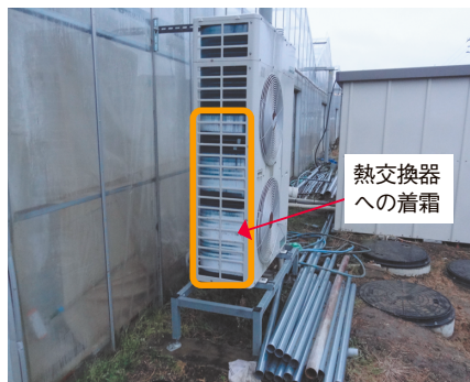
写真1 空気熱源ヒートポンプ熱交換器へ付着した霜
