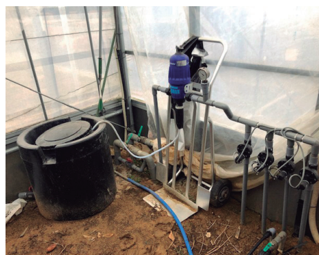
写真1 液肥用タンク・液肥混入器・電磁弁
