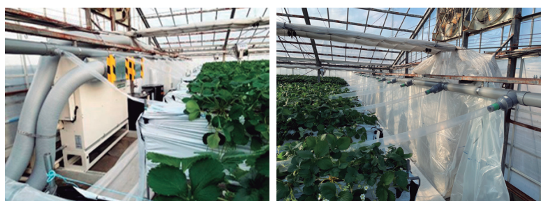
写真1 水熱源ヒートポンプを利用した局所環境制御
