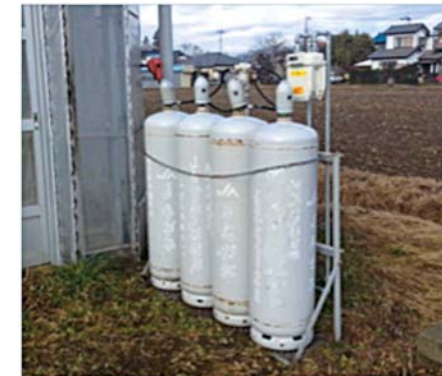
ハウスの横に容器とメーターを設置してガスを供給します
