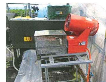
▲設置写真(加温機隣接設置)
