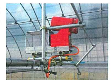
▲設置写真(天井吊設置)
