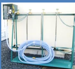
2)炭酸ガス供給装置
