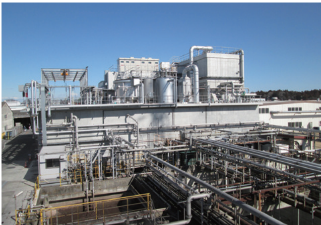
排水処理施設
