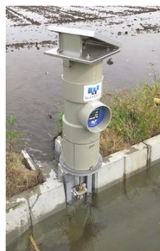
▲開水路の設置例
