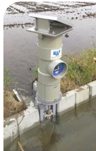
▼開水路の設置例
