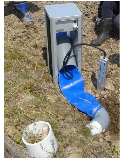
自動給水装置の設置状況
